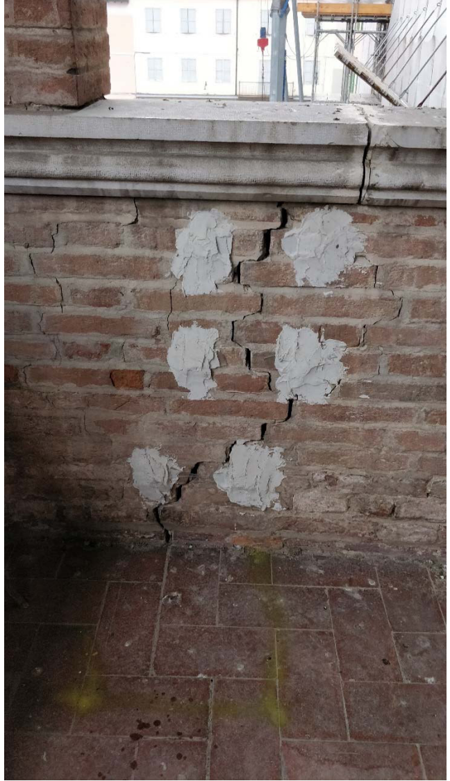
Lesioni connesse al ribaltamento della facciata
