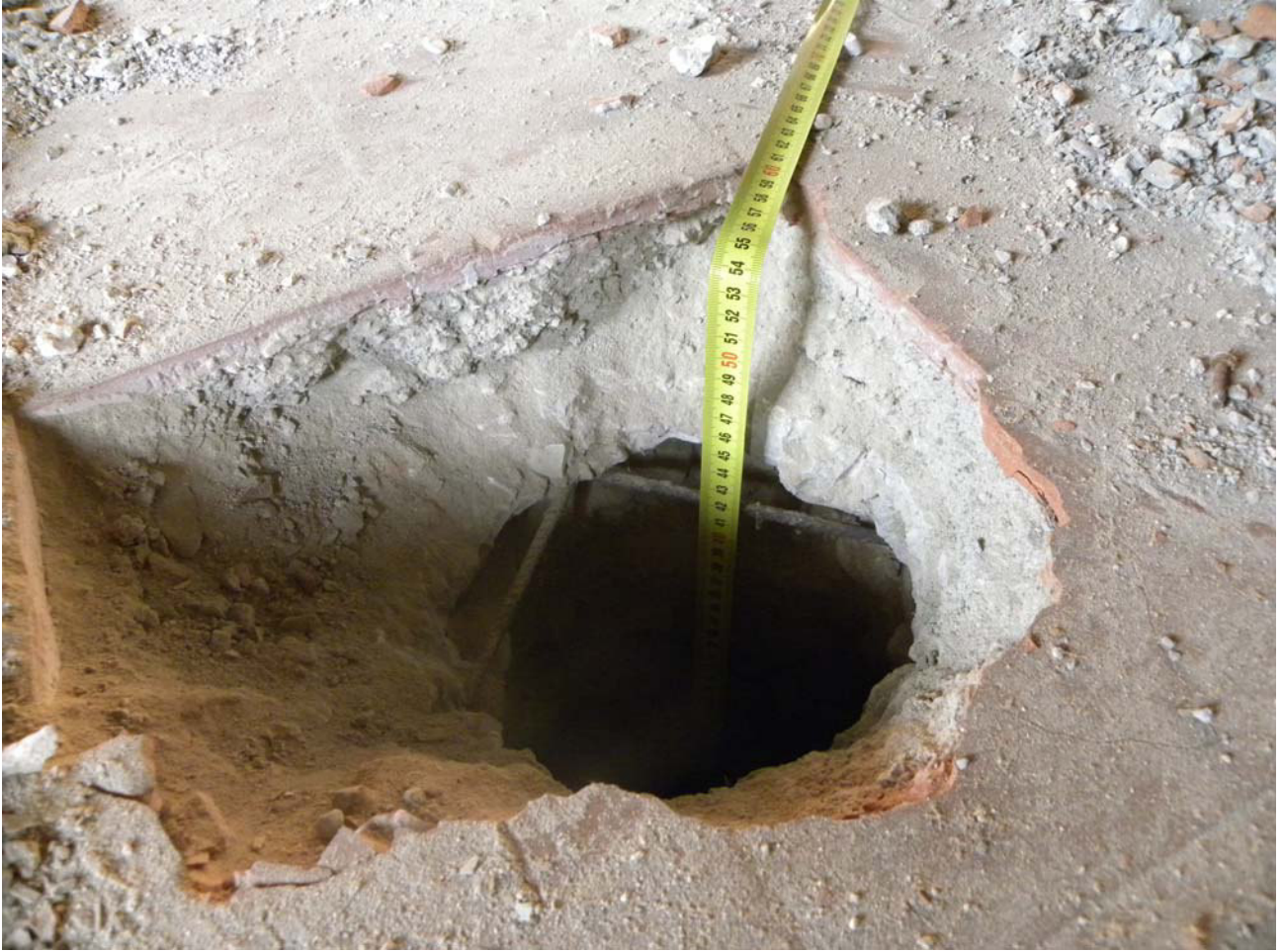
Il sondaggio eseguito nel pavimento del Salone con individuata la soletta in c.c.a.
