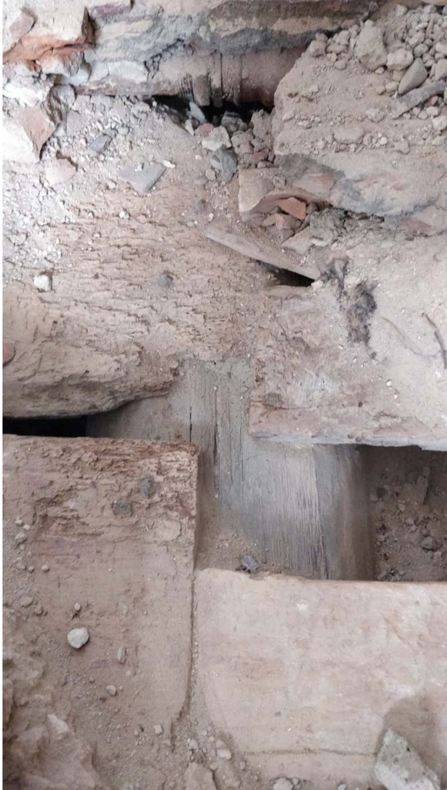
Sondaggio sul solaio di piano secondo che evidenzia la presenza di grosse travi lignee e un singolo tavolato soprastante in scarse condizioni di conservazione (sondaggio S5)
