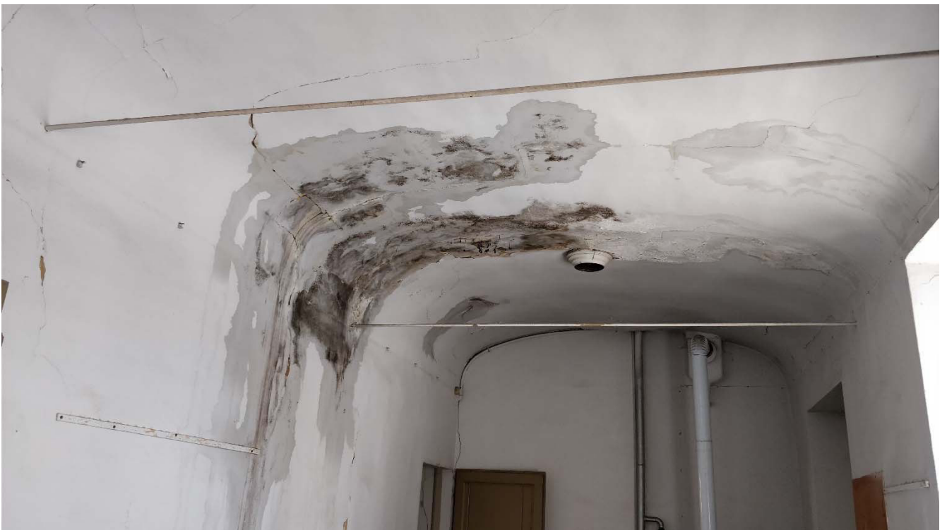
Vista dei locali interni con evidenti segni di degrado dovuto ad infiltrazioni di acque meteoriche dalla copertura
