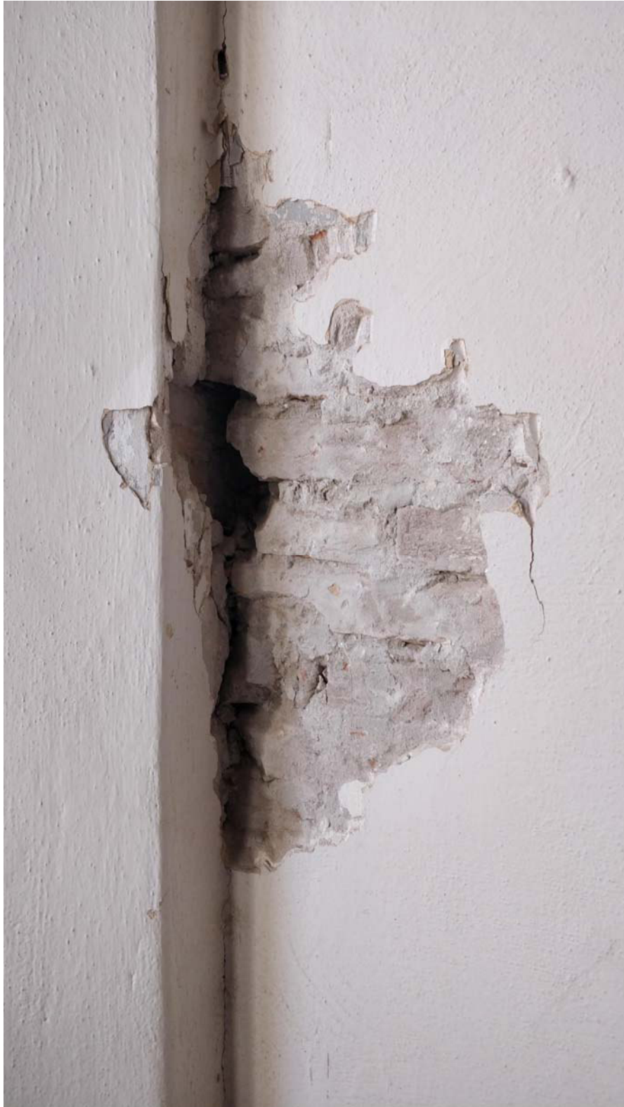
Sondaggio su una delle pareti interne ai locali del secondo piano (Ex scuola di musica) che evidenzia la tessitura muraria in mattoni pieni non opportunamente ammorsati ai paramenti perimetrali (sondaggio S8)
